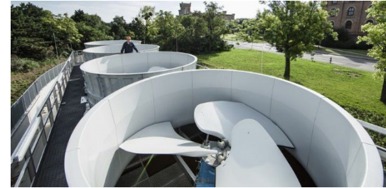
Rückkühlwerk der Fernkältezentrale Hauptbahnhof, Wien Energie
