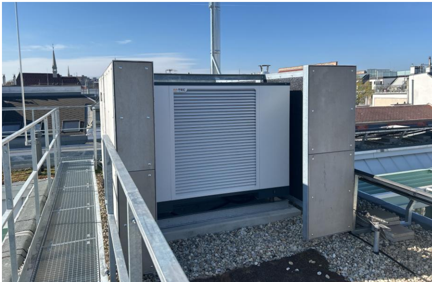
Wärmepumpen mit Schall- und Sichtschutzwänden
